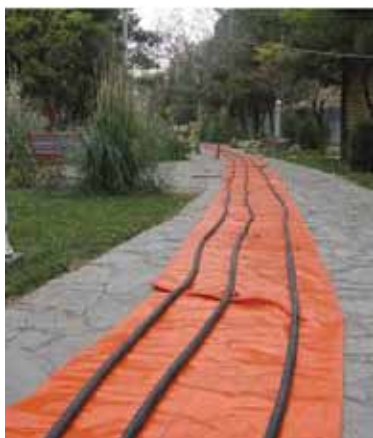
شکل ۹: کابل‌های ارتباطی پهن شده روی کفپوش مخصوص
